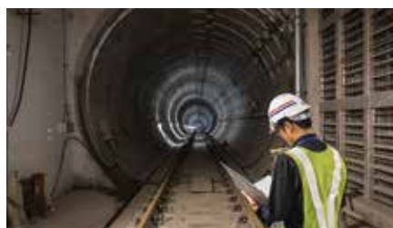
道路・トンネル ▶ 設備保守
